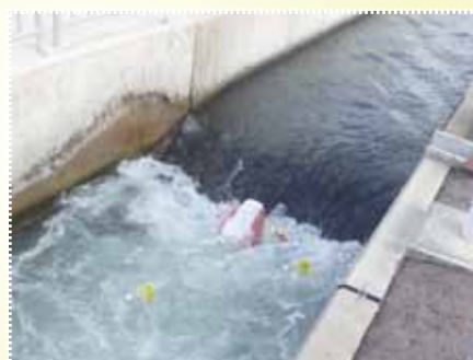
ゴミが浮遊している落差工
